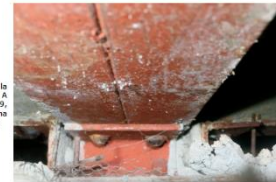
Conexión de la viga del eje A entre ejes 6 y 5, con la columna de los ejes 6-A
